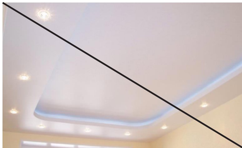
Плохо Многоуровневые гипсокартонные конструкции
